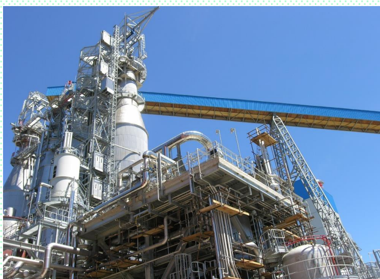
CELCO Arauco – Fábrica de Nueva Aldea - Chile
